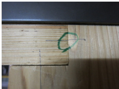
写真 8. 7. 1-237 垂れ壁と壁間のずれ
