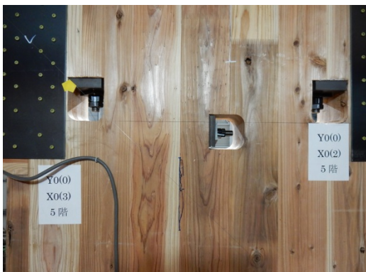
写真 8.7.1-329 各引きボルトの緩み
