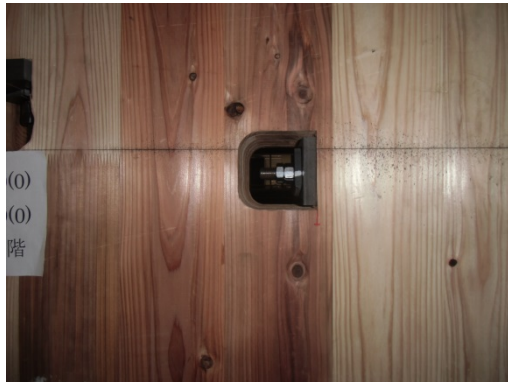
写真 8. 7. 1-155 壁-垂れ壁引きボルトの割れ
