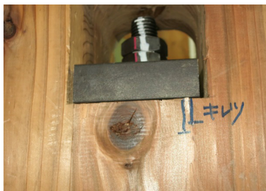
写真 8.7.1-146 引きボルト座金下部の亀裂
