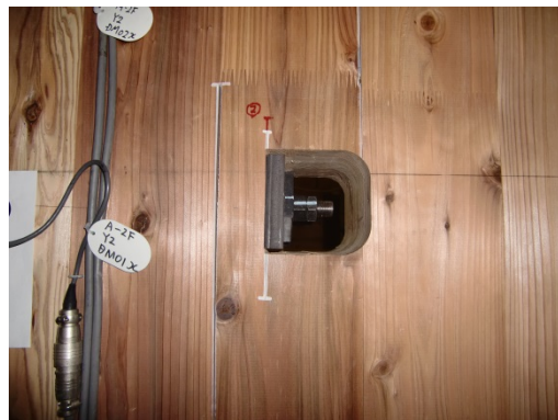
写真 8.7.1-163 壁-垂れ壁引きボルトの割れ
