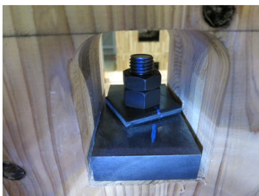
写真 8.7.1-271 壁-壁引きボルトの緩み
