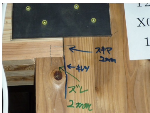
写真 8.7.1-144 垂れ壁-壁の開き
