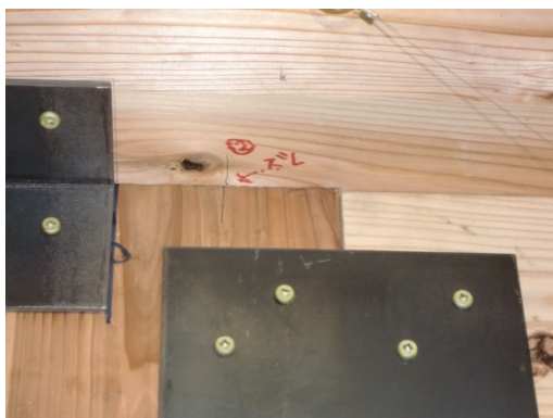
写真 8. 7. 1-159 壁パネルのずれ
