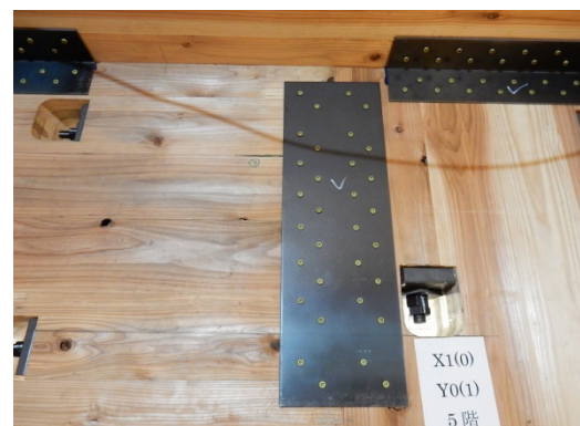
写真 8. 7. 1-320 ラミナ継ぎ目の割れ
