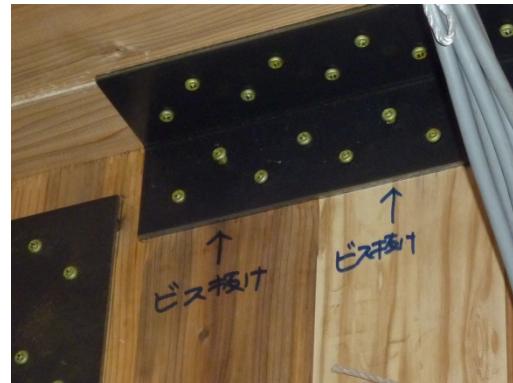
写真 8. 7. 1-117 L形せん断プレート ビスの引き抜け
