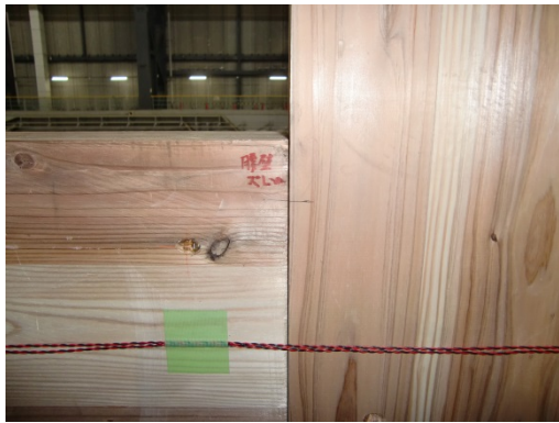
写真 8.7.1-161 壁パネルのずれ
