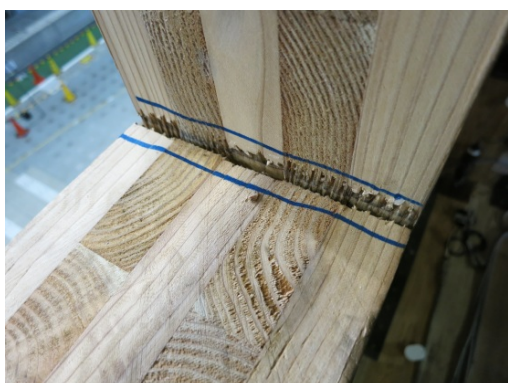
写真 8. 7. 1-253 腰壁と壁の開き
