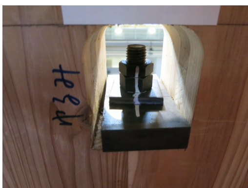
写真 8. 7. 1-259 壁-壁引きボルトの緩み
