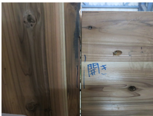
写真 8. 7. 1-257 壁と腰壁の開き
