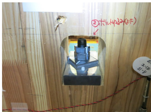
写真 8.7.1-60 壁-基礎引きボルトの緩み
