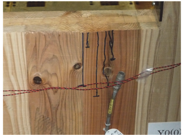
写真 8.7.2-51 壁パネル割れ
