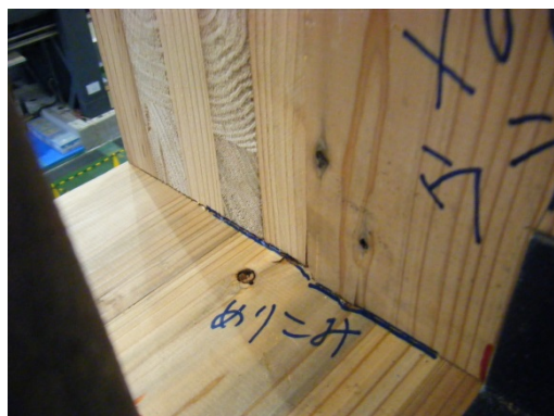
写真 8.7.1-307 壁パネルの床へのめり込み
