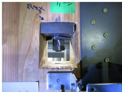
写真 8.7.1-248 引きボルトのナットの緩み
