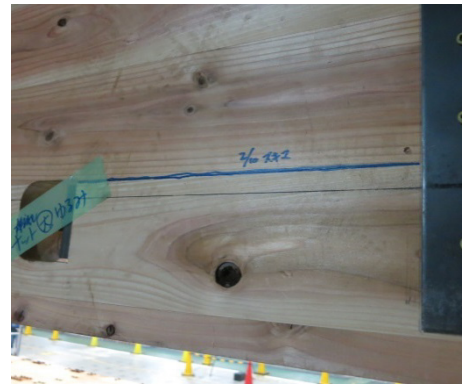
写真 8.7.1-105 垂れ壁-壁引きボルトの緩み とラミナ間の隙間
