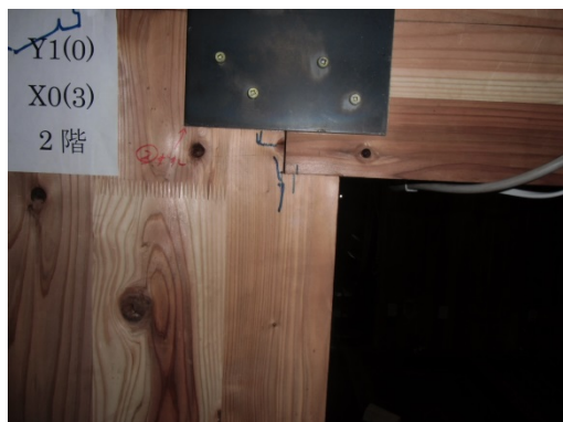
写真 8.7.1-202 垂れ壁パネル隅の割れ
