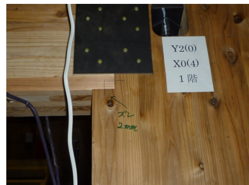
写真 8.7.1-82 垂れ壁と壁のずれ
