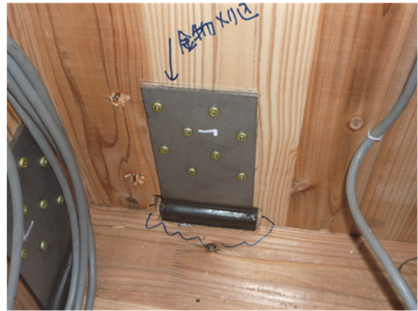
写真 8.7.2-46 U形引張金物めり込み
