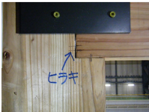
写真 8. 7. 1-305 垂れ壁と壁の開き
