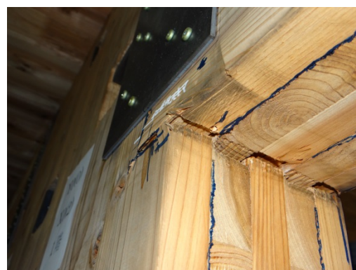
写真 8. 7. 1-122 壁パネル面内の割れ
