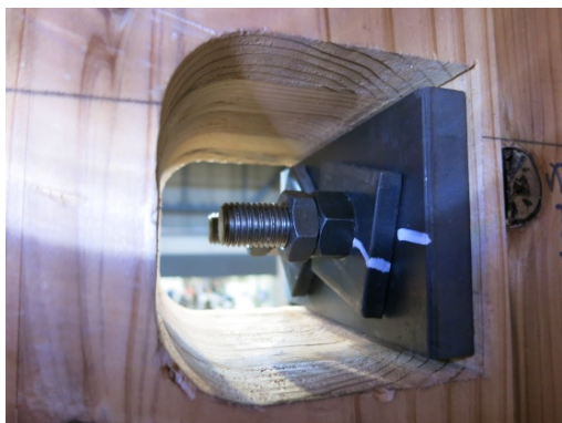
写真 8.7.1-241 引きボルトのナットの緩み
