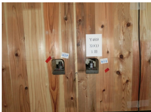
写真 8. 7. 1-43 壁-基礎引きボルトの緩み
