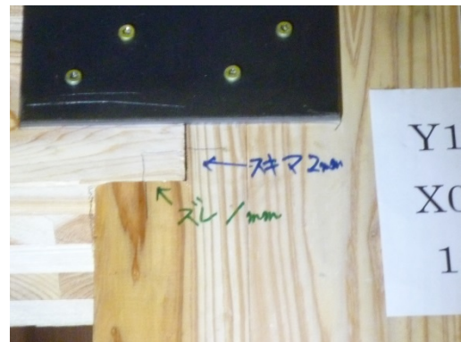
写真 8. 7. 1-132 垂れ壁-壁の開き
