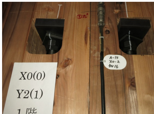
写真 8.7.1-56 壁パネル間のずれ
