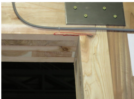
写真 8. 7. 1-55 垂れ壁と壁取り合い部の潰れ
