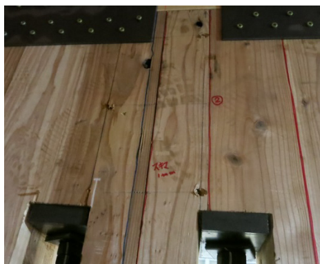
写真 8. 7. 1-150 ラミナ継ぎ目の割れ
