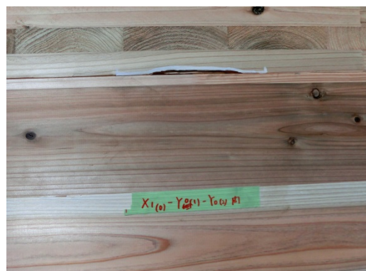
写真 8.7.1-5 吊り時のめり込み
