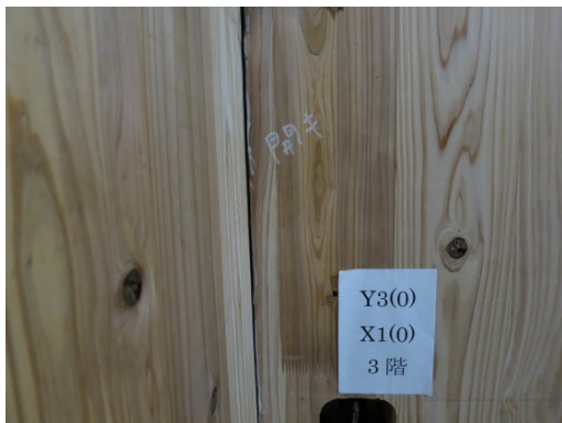
写真 8. 7. 1-227 壁と直交壁の開き
