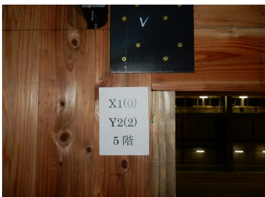
写真 8. 7. 1-319 垂れ壁と壁取り合い部からの 割れ
