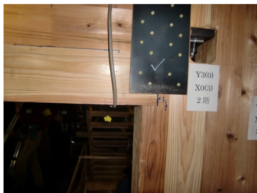
写真 8. 7. 1-213 垂れ壁パネル隅の割れ
