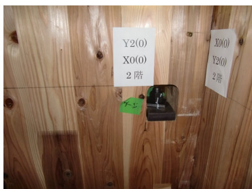
写真 8. 7. 1-173 壁-壁引きボルトの緩み
