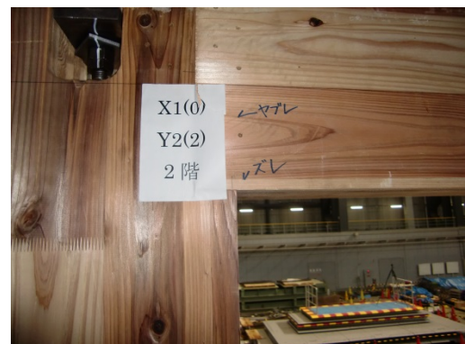
写真 8. 7. 1-190 垂れ壁パネルの開き
