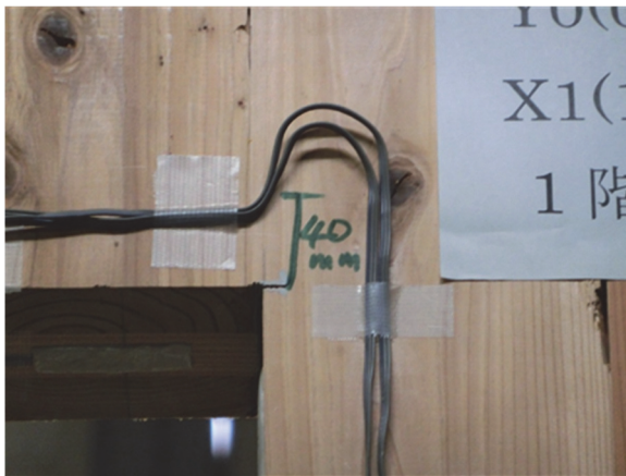
写真 8.7.2-28 壁パネルの割れ
