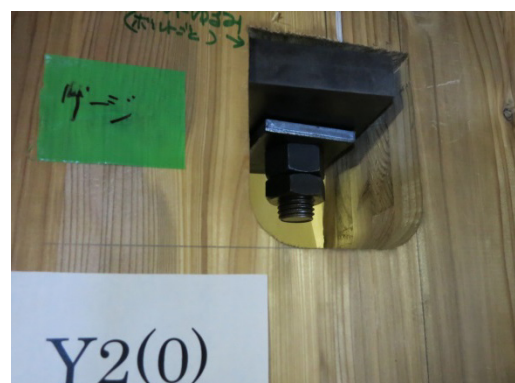
写真 8.7.1-78 壁-屋根引きボルトの緩み
