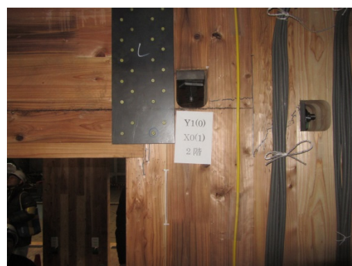
写真 8.7.1-199 壁パネルの割れ
