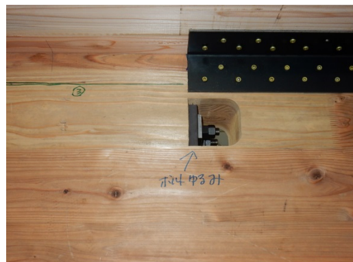
写真 8.7.1-323 垂れ壁-壁引きボルトの緩み
