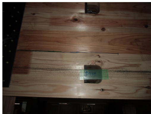
写真 8.7.1-179 垂れ壁パネルのラミナ割れ
