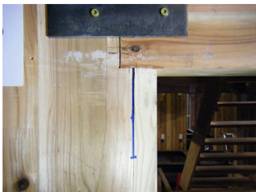
写真 8. 7. 1-312 垂れ壁と壁の取り付け部からの割れ
