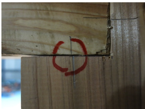
写真 8. 7. 1-233 壁と垂れ壁間のずれ
