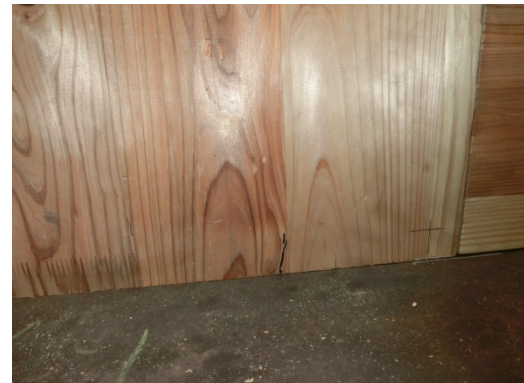
写真 8.7.1-32 壁と基礎の接触面からの割れ
