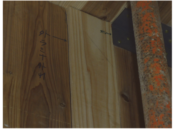
写真 8.7.2-37 壁パネルのラミナ剥離
