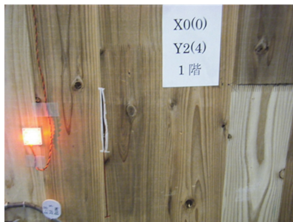
写真 8.7.2-2 壁パネルの割れ
