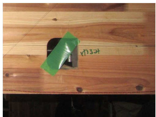
写真 8. 7. 1-175 壁-垂れ壁引きボルトの緩み
