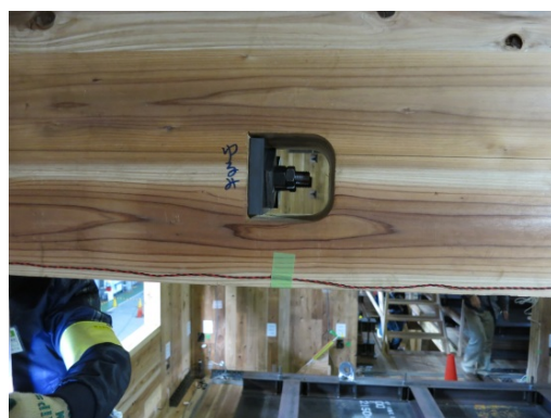
写真 8.7.1-276 腰壁-壁引きボルトの緩み
