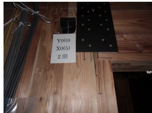
写真 8.7.1-197 壁パネルの割れ
