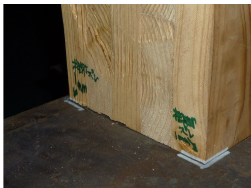
写真 8.7.1-81 壁パネルのずれ
