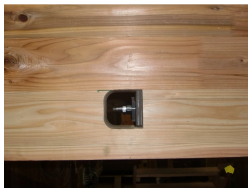
写真 8. 7. 1-177 壁-垂れ壁引きボルトの割れ
