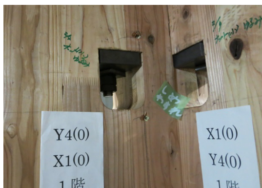
写真 8.7.1-87 壁-屋根引きボルトの緩み
