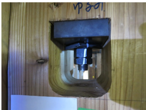
写真 8.7.1-280 壁-壁引きボルトの緩み
