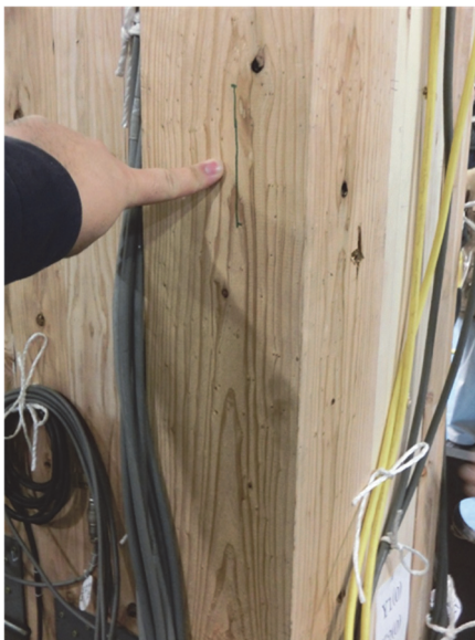
写真 8.7.2-25 壁パネルの割れ
