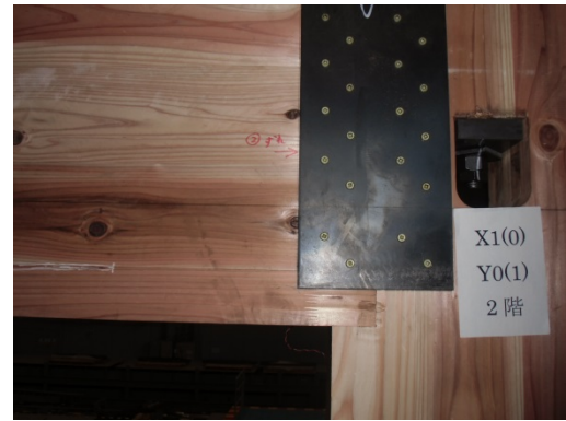
写真 8.7.1-162 せん断プレートのずれ
