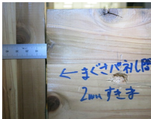
写真 8. 7. 1-102 壁-腰壁の開き
