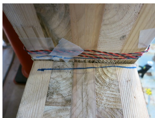
写真 8.7.1-244 腰壁の壁パネルへのめり込み
