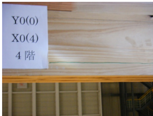
写真 8. 7. 1-301 表層ラミナの割れ Y1 通り 損傷写真なし
