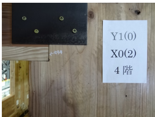
写真 8. 7. 1-295 垂れ壁と壁の開き
