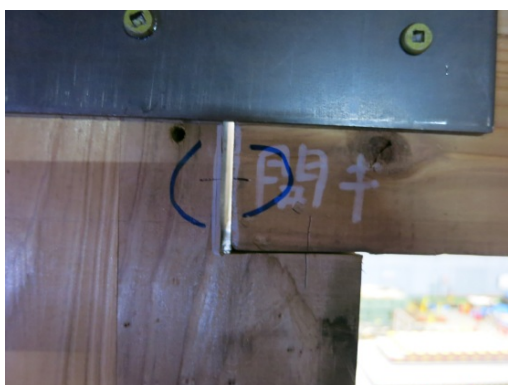
写真 8. 7. 1-263 垂れ壁と壁の開き
