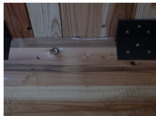
写真 8. 7. 1-296 壁パネルの潰れ
