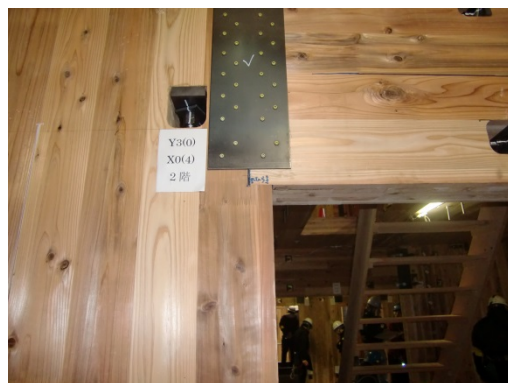
写真 8. 7. 1-214 垂れ壁パネル隅の割れ
