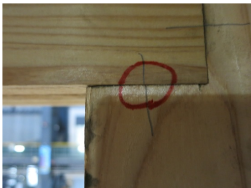
写真 8. 7. 1-232 壁と垂れ壁間のずれ
