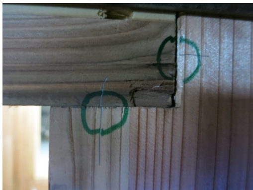
写真 8. 7. 1-240 垂れ壁と壁のずれ
