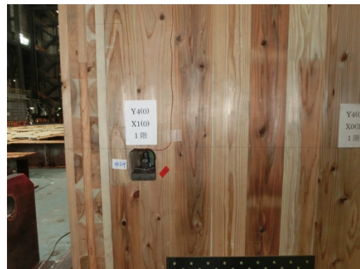
写真 8.7.1-42 壁-基礎引きボルトの緩み
