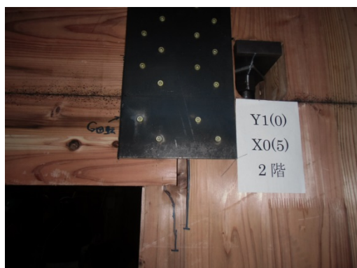
写真 8.7.1-204 垂れ壁パネル隅の割れ
