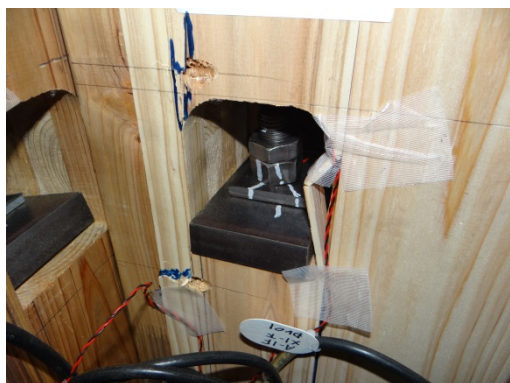
写真 8. 7. 1-119 切欠き部からの割裂
