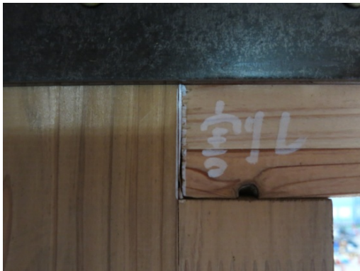
写真 8. 7. 1-223 垂れ壁と壁のずれ
