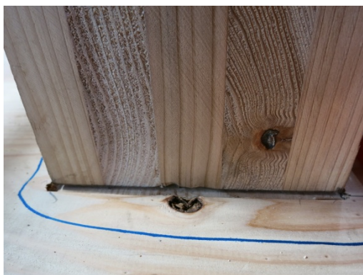
写真 8.7.1-273 壁パネル下部の浮き Y1 通り
