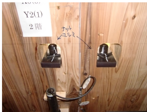
写真 8. 7. 1-186 壁-壁引きボルトの緩み
