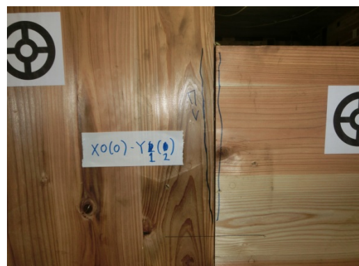
写真 8.7.1-24 壁と腰壁とり合い部の割れ
