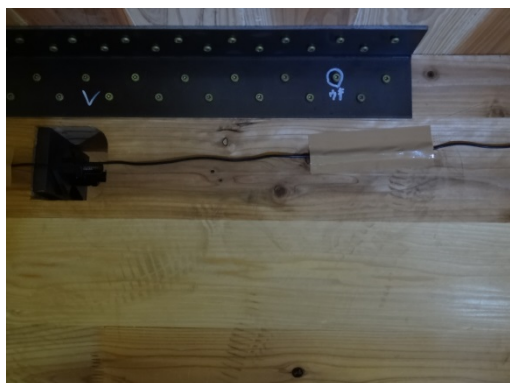
写真 8. 7. 1-298 L 形せん断金物のビスの浮き Y3 通り
