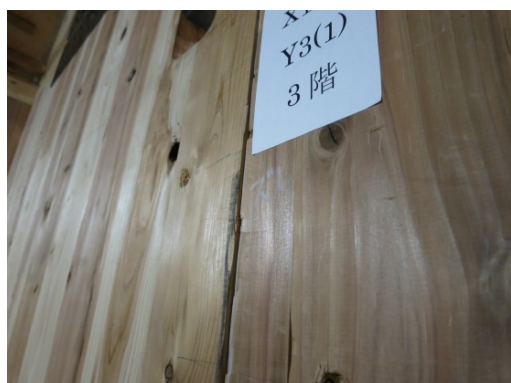
写真 8.7.1-217 壁と壁のずれ
