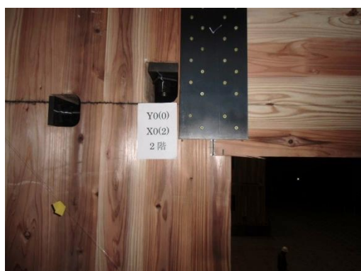
写真 8. 7. 1-169 垂れ壁パネルのずれ
