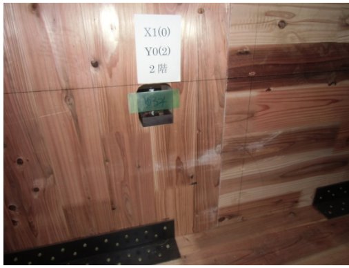
写真 8.7.1-193 壁-壁引きボルトの割れ Y0 通り
