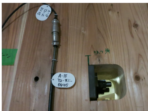
写真 8.7.1-79 切欠き部からの亀裂
