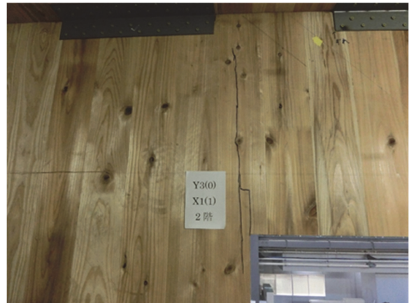
写真 8.7.2-53 壁パネル割れ
