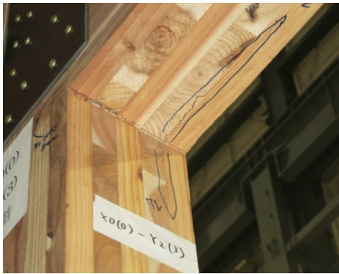
写真 8.7.1-104 垂れ壁と壁側面の割れ
