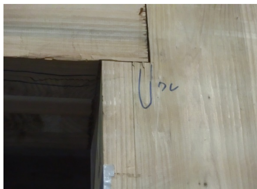
写真 8.7.1-25 垂れ壁と壁とり合い部の割れ
