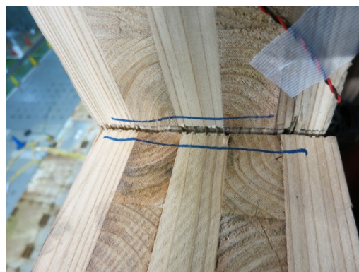
写真 8. 7. 1-258 腰壁と壁の開き
