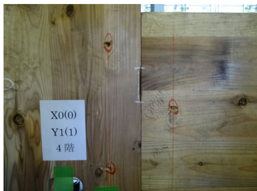
写真 8. 7. 1-287 壁と腰壁継ぎ目の開き
