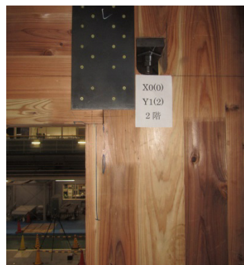
写真 8.7.1-185 壁パネルラミナ継目の割れ
