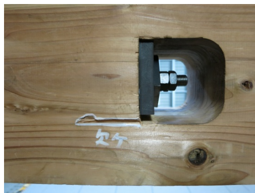
写真 8. 7. 1-231 垂れ壁パネルの欠け
