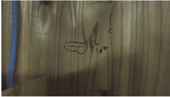
写真 8.7.2-45 壁パネルずれ
