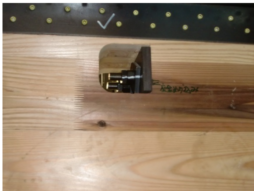
写真 8. 7. 1-168 壁-垂れ壁引きボルトのめり 込み
