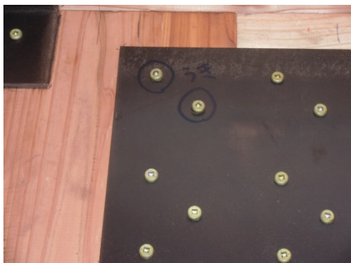
写真 8.7.1-178 せん断プレートビスの浮き
