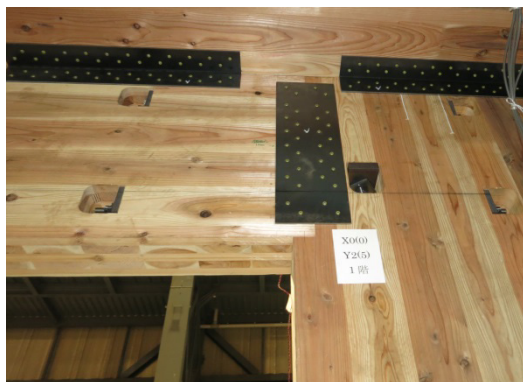
写真 8. 7. 1-66 垂れ壁-壁間せん断プレートの ずれ
