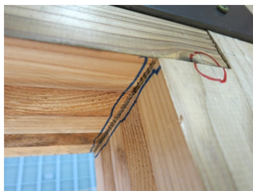
写真 8.7.1-272 垂れ壁と壁の開き
