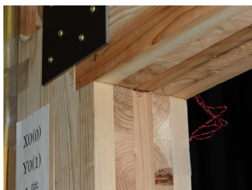
写真 8.7.1-90 壁-垂れ壁せん断プレートずれ
