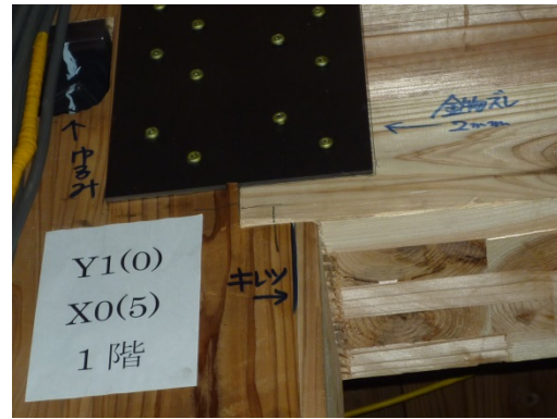
写真 8. 7. 1-136 垂れ壁-壁間せん断プレート のずれ
