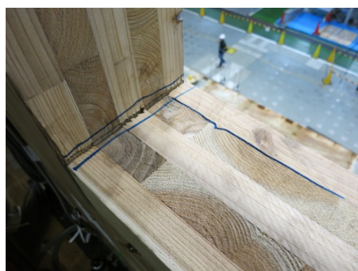
写真 8. 7. 1-252 腰壁と壁の開き
