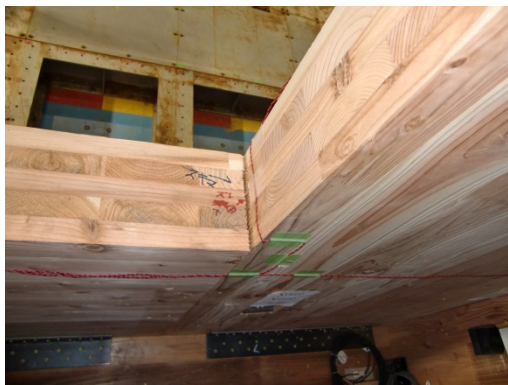
写真 8. 7. 1-188 腰壁パネルの開き X1 通り
