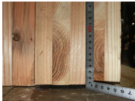
写真 8. 7. 1-44 壁パネルの浮き 5mm
