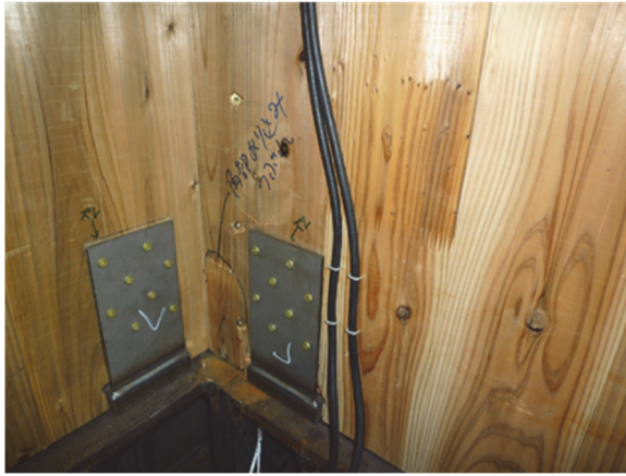
写真 8.7.2-36 壁パネルつぶれ
