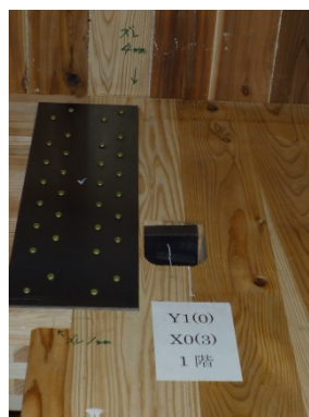
写真 8.7.1-75 屋根と壁、垂れ壁と壁のずれ
