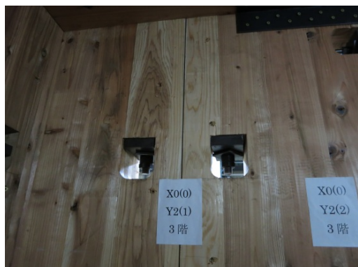
写真 8.7.1-215 壁と壁との開き
