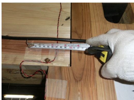
写真 8.7.1-15 垂れ壁-壁間開き
