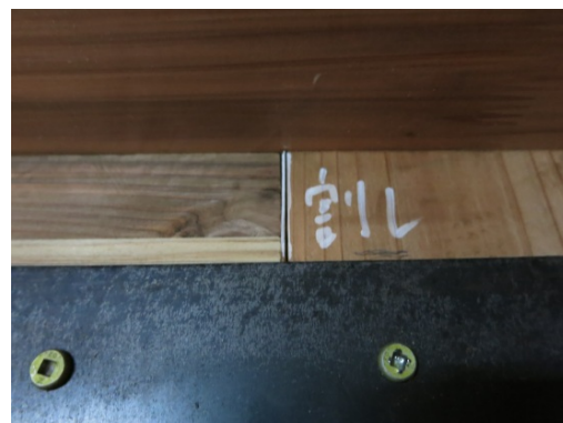
写真 8.7.1-216 壁と垂れ壁間の割れ
