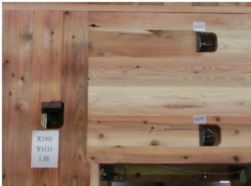
写真 8.7.1-27 壁-垂れ壁引きボルトの緩み
