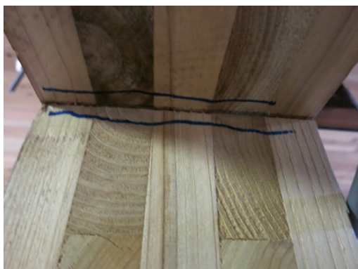
写真 8.7.1-282 垂れ壁と壁の取り合い部の潰れ
