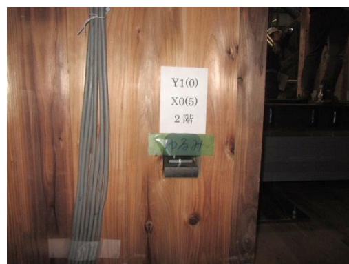
写真 8.7.1-205 壁-壁引きボルトの緩み
