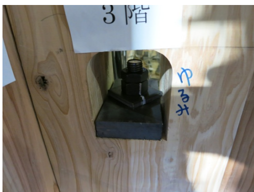
写真 8.7.1-275 壁-壁引きボルトの緩み
