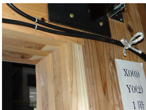
写真 8.7.1-92 壁-垂れ壁せん断プレートずれ
