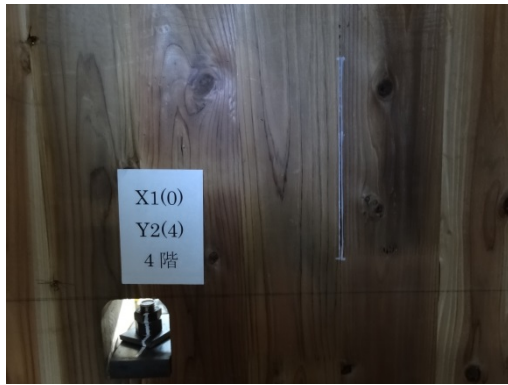
写真 8. 7. 1-292 ラミナ継ぎ目の開き Y0 通り
