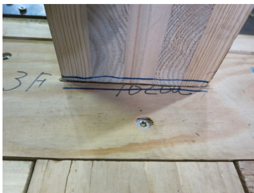
写真 8.7.1-277 壁パネル下部の床へのめり込み
