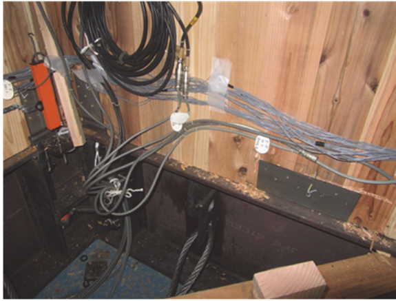
写真 8.7.2-26 U形せん断金物のねじ抜け
