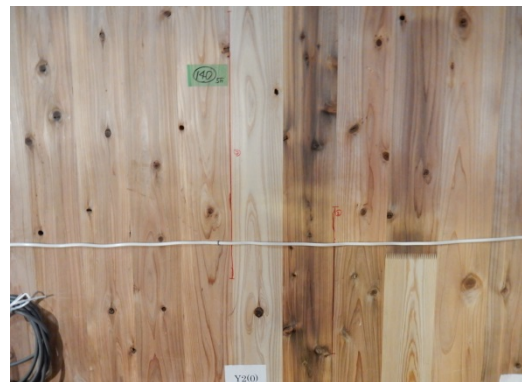
写真 8.7.1-316 ラミナの継ぎ目の割れ
