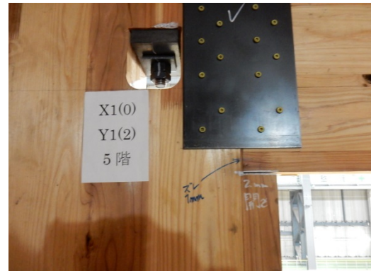
写真 8.7.1-328 壁と垂れ壁のずれ
