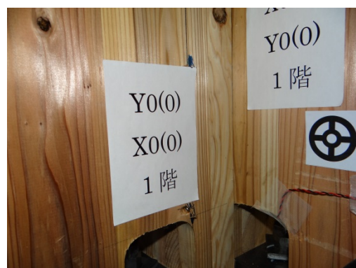
写真 8. 7. 1-120 切欠き部からの割裂
