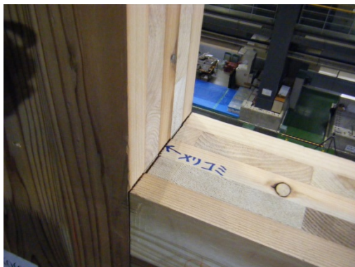
写真 8. 7. 1-304 壁と腰壁の取り付け部のめり込み
