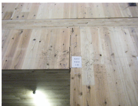
写真 8.7.2-9 壁パネルの割れ
