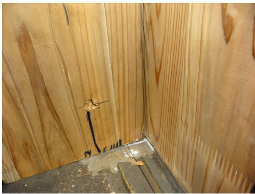
写真 8. 7. 1-137 壁パネル下部の潰れ Y2 通り
