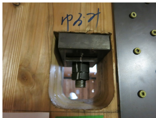
写真 8.7.1-281 壁-壁引きボルトの緩み
