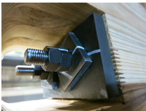
写真 8. 7. 1-238 引きボルトナットの緩み
