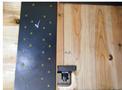
写真 8. 7. 1-306 引きボルト埋込部の割れ
