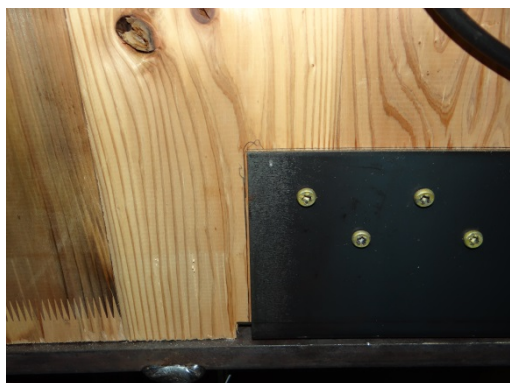
写真 8.7.1-71 U形せん断プレートのずれ
