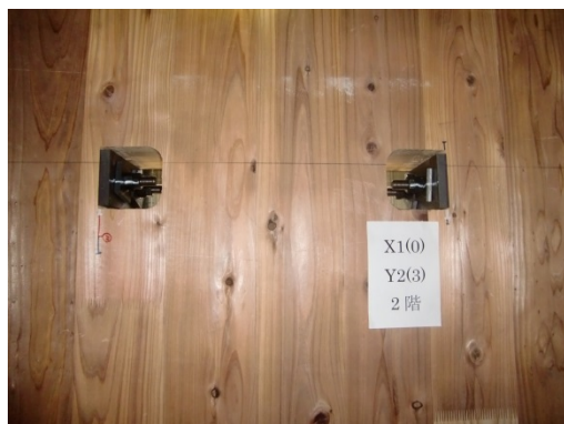
写真 8. 7. 1-189 壁パネル継目の割れ
