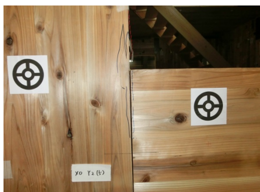
写真 8.7.1-21 壁と腰壁とり合い部の割れ
