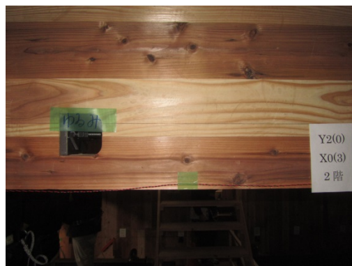
写真 8. 7. 1-211 壁-垂れ壁引きボルトの緩み
