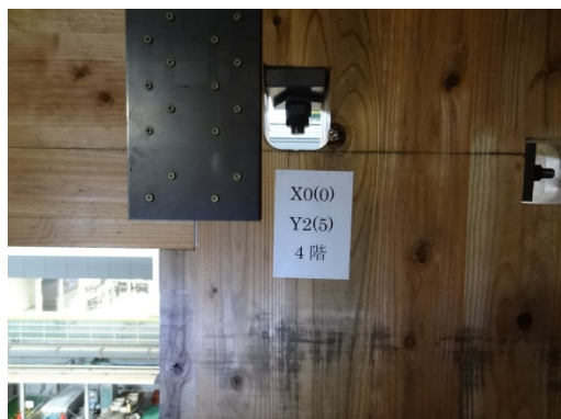
写真 8. 7. 1-289 垂れ壁と壁の開き
