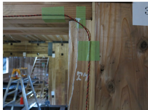
写真 8. 7. 1-225 壁パネルの欠け
