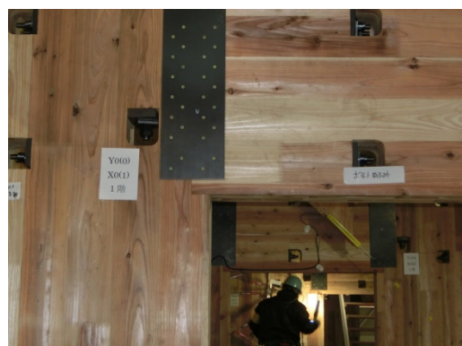
写真 8.7.1-17 垂れ壁-壁引きボルトの緩み
