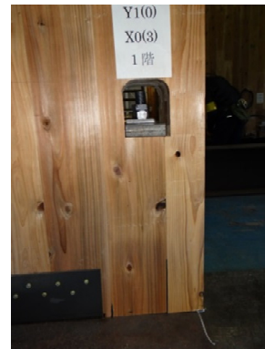
写真 8. 7. 1-130 壁-基礎引きボルトの緩み
