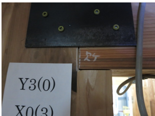
写真 8. 7. 1-229 壁と垂れ壁取り付け部の欠け
