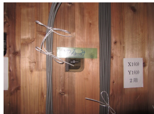
写真 8. 7. 1-192 壁-垂れ壁引きボルトの緩み
