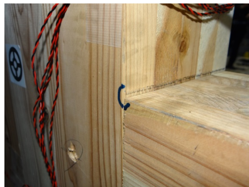
写真 8.7.1-89 壁-腰壁の開き
