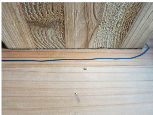
写真 8.7.1-269 壁パネル下部の床へのめり込み
