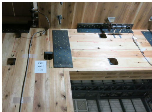
写真 8.7.1-85 壁パネルの割れ
