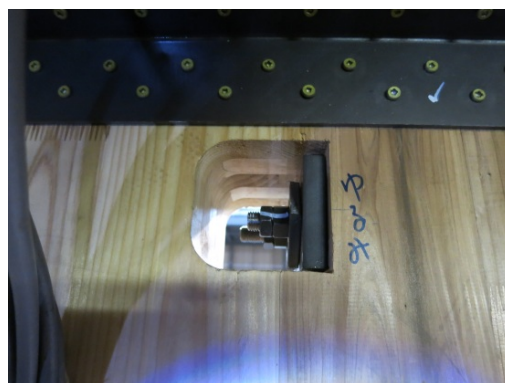
写真 8.7.1-246 引きボルトのナットの緩み
