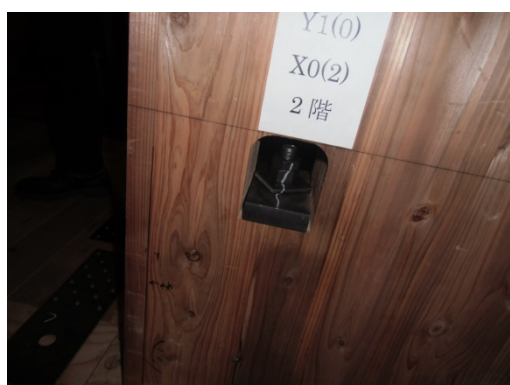
写真 8.7.1-200 壁-壁引きボルトの緩み
