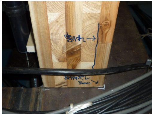
写真 8. 7. 1-114 壁パネル面内の割れ
