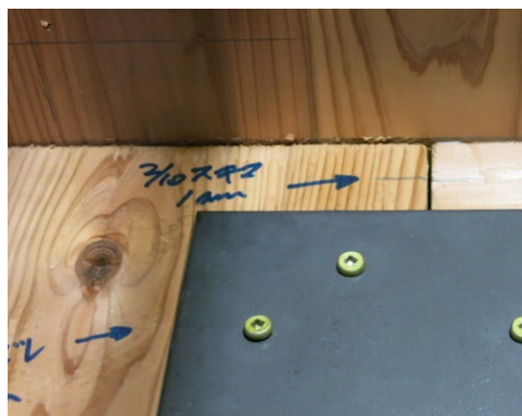
写真 8.7.1-148 壁パネル間の隙間
