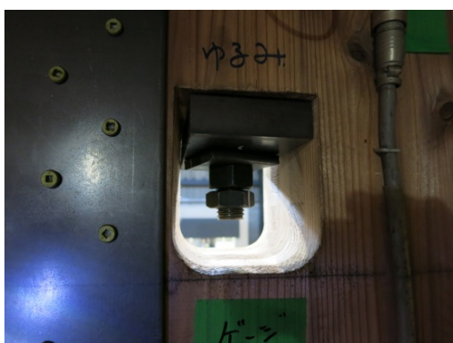
写真 8.7.1-243 引きボルトのナットの緩み
