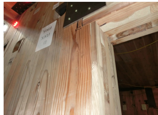
写真 8.7.1-34 垂れ壁側面の割れ
