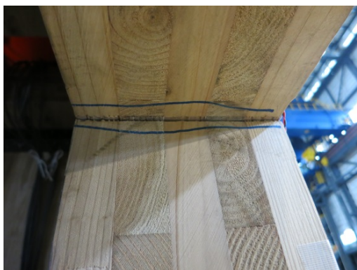
写真 8.7.1-265 壁と腰壁の開き
