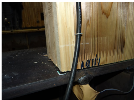
写真 8. 7. 1-123 壁パネル下部の潰れ Y1 通り
