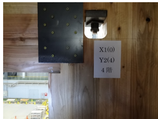
写真 8. 7. 1-291 垂れ壁と壁の開き
