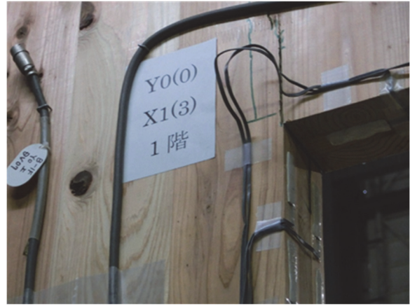
写真 8.7.2-27 壁パネルの割れ
