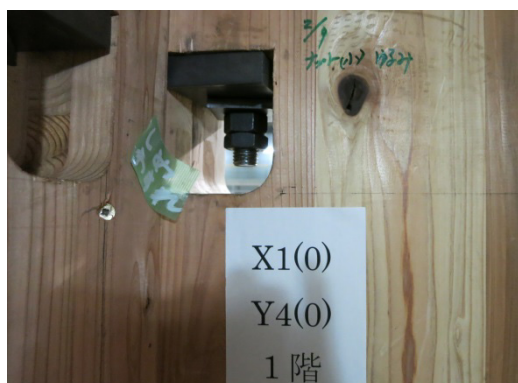
写真 8. 7. 1-67 壁-屋根引きボルトの緩み
