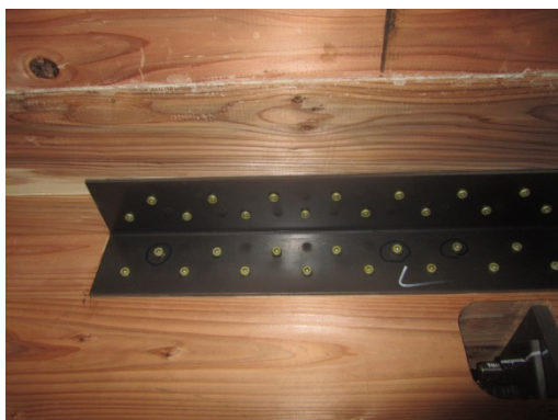
写真 8. 7. 1-206 L 形プレートビスの浮き
