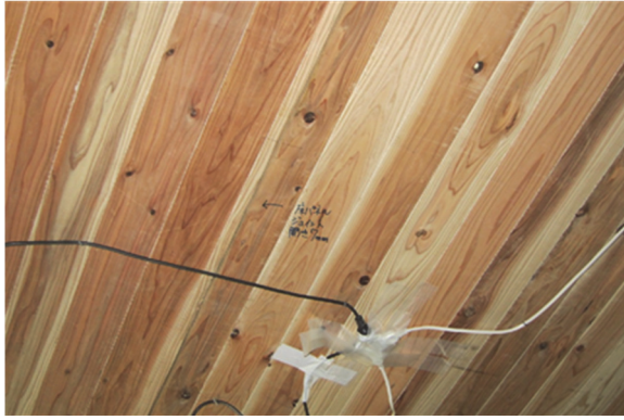
写真 8.7.2-38 床パネルずれ
