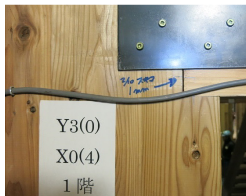
写真 8.7.1-147 壁と垂れ壁間の隙間
