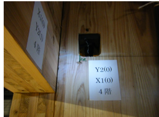
写真 8. 7. 1-303 切欠き部からの割れ
