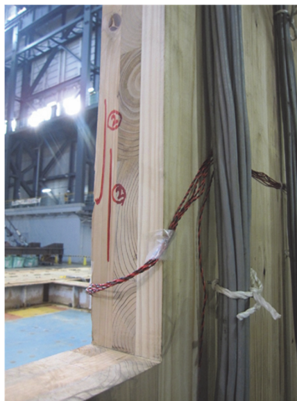
写真 8.7.2-19 壁パネルの割れ
