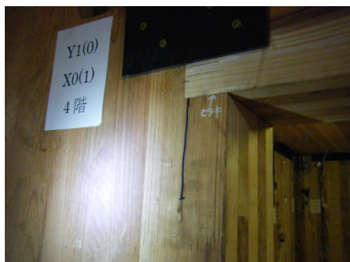
写真 8.7.1-309 垂れ壁と壁の取り合い部からの割れ
