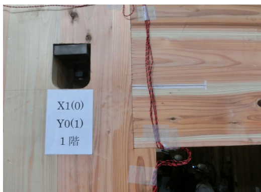
写真 8.7.1-4 垂れ壁の割れ
