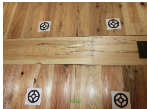
写真 8.7.1-20 床パネル内の割れ
