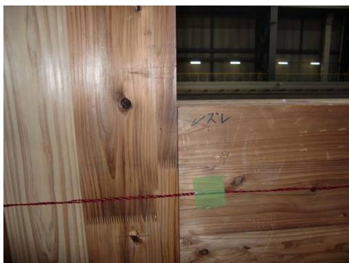
写真 8. 7. 1-191 腰壁パネルのずれ
