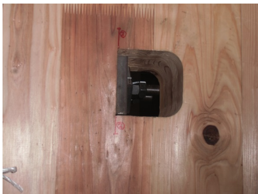
写真 8. 7. 1-156 壁-垂れ壁引きボルトの割れ
