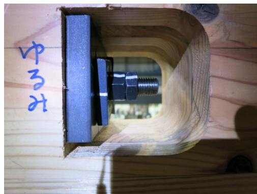
写真 8.7.1-242 引きボルトのナットの緩み
