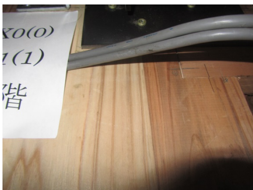
写真 8.7.1-182 垂れ壁パネルの開き
