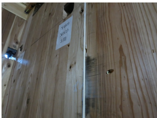
写真 8. 7. 1-230 壁と壁のずれ
