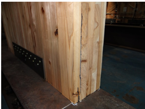
写真 8. 7. 1-131 壁パネル下部の潰れと面内割れ
