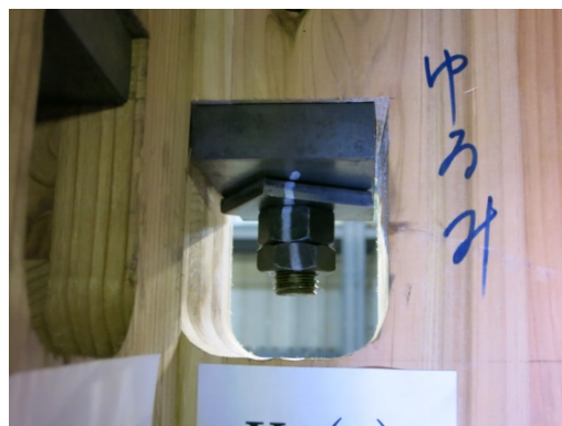
写真 8.7.1-266 壁-壁引きボルトの緩み
