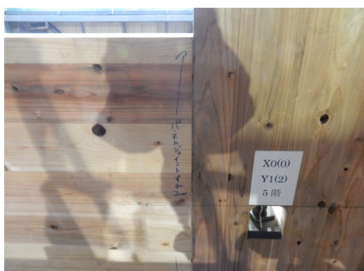
写真 8.7.1-324 腰壁と壁パネルのずれ
