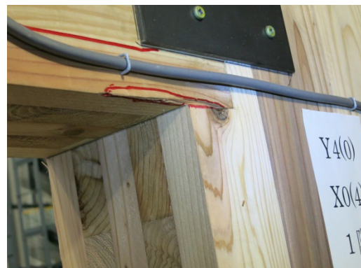
写真 8. 7. 1-65 垂れ壁と壁取り合い部の潰れ
