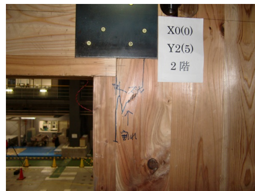
写真 8. 7. 1-187 垂れ壁パネル隅の割れ
