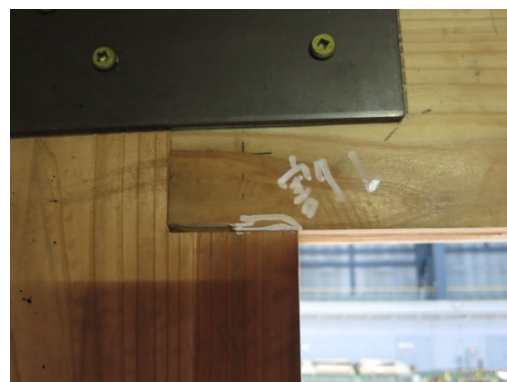
写真 8.7.1-220 壁と垂れ壁間の割れ
