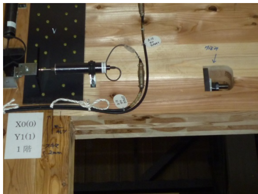
写真 8. 7. 1-98 垂れ壁-壁引きボルトの緩み
