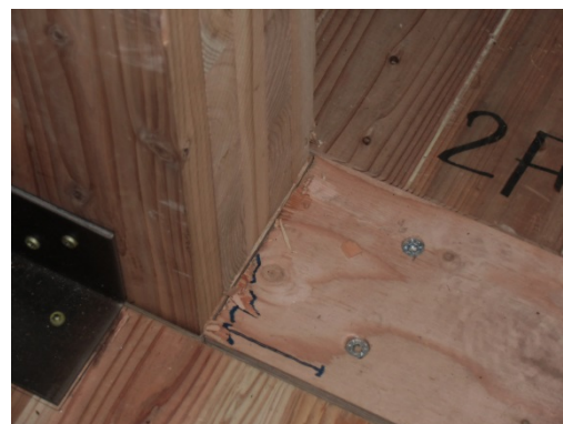
写真 8.7.1-203 壁パネルのめり込み
