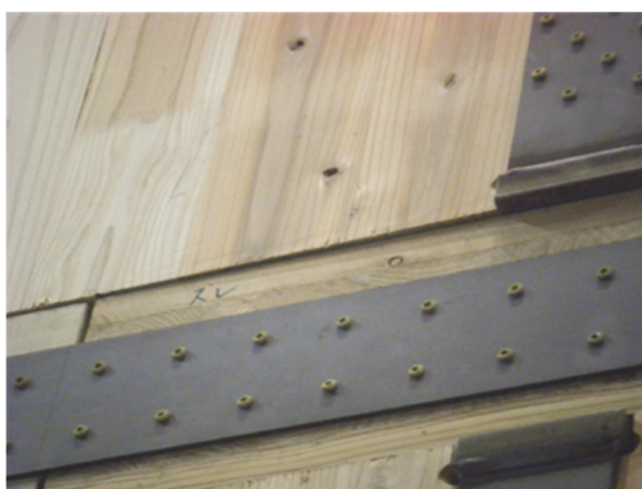
写真 8.7.2-3 壁パネルの面外ずれ
