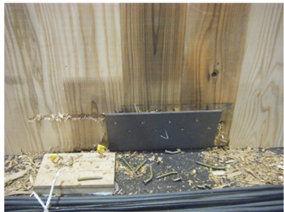
写真 8.7.2-14 U形せん断金物のねじ抜け
