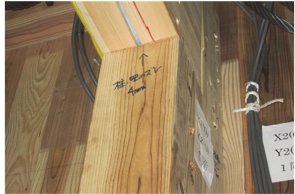
写真 8.7.2-33 柱・梁のずれ
