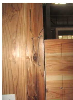
写真 8.7.1-181 壁パネルのめり込み
