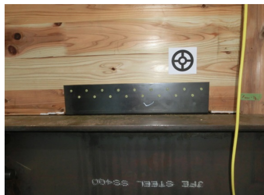
写真 8.7.1-2 U 形せん断金物の浮き
