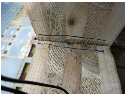
写真 8.7.1-245 腰壁の壁パネルへのめり込み
