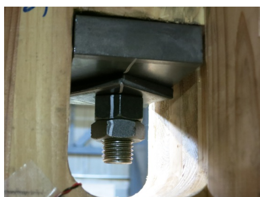
写真 8. 7. 1-262 壁-壁引きボルトの緩み
