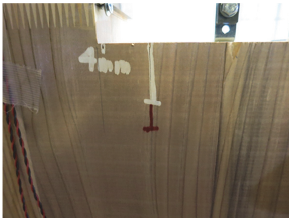
図 8.7.2-49 壁パネル割れ
