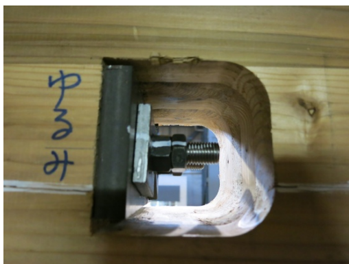
写真 8. 7. 1-249 垂れ壁-壁引きボルトの緩み
