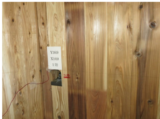
写真 8. 7. 1-54 壁-基礎引きボルトの緩み
