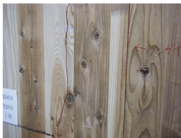
写真 8.7.2-4 壁パネルの面外ずれ
