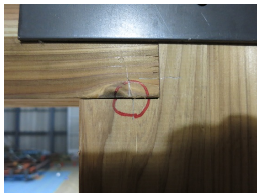
写真 8. 7. 1-234 壁と垂れ壁間のずれ
