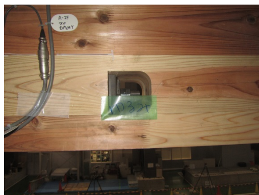
写真 8.7.1-183 壁-垂れ壁引きボルトの緩み
