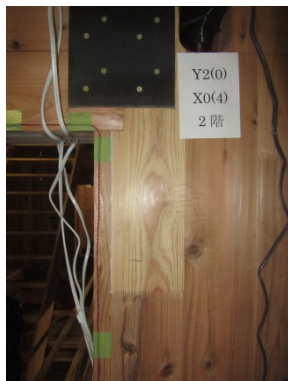
写真 8. 7. 1-154 ラミナ継目の割れ
