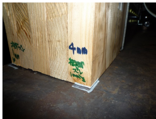
写真 8.7.1-143 壁パネル下部のずれ
