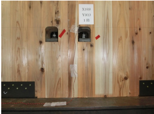
写真 8. 7. 1-12 基礎-壁引きボルトの緩み
