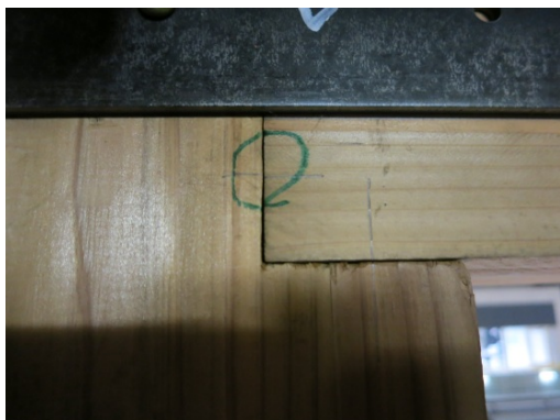
写真 8. 7. 1-236 垂れ壁と壁間のずれ
