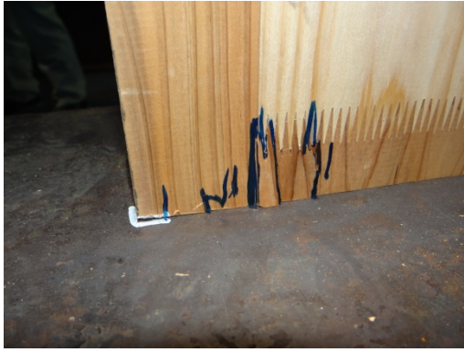
写真 8. 7. 1-127 壁パネル下部の潰れ
