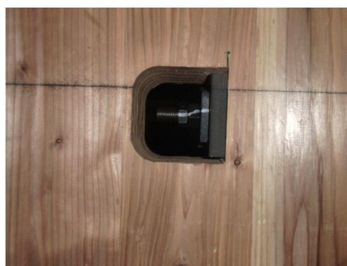
写真 8. 7. 1-171 壁-垂れ壁引きボルトの割れ
