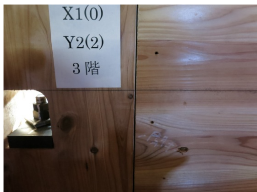
写真 8.7.1-219 壁と腰壁の開き
