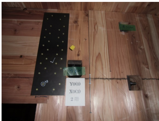
写真 8.7.1-196 壁パネルのラミナ継目割れ
