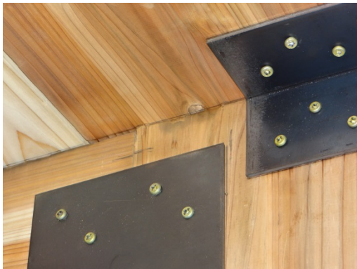
写真 8. 7. 1-129 パネル間の段差
