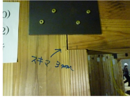
写真 8. 7. 1-128 垂れ壁-壁の開き
