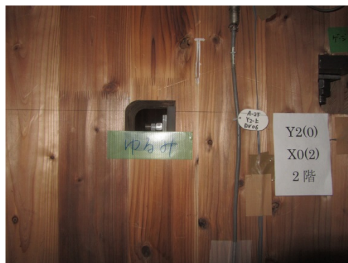
写真 8. 7. 1-207 壁-垂れ壁引きボルトの緩み
