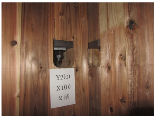
写真 8. 7. 1-212 壁-壁引きボルトの割れ
