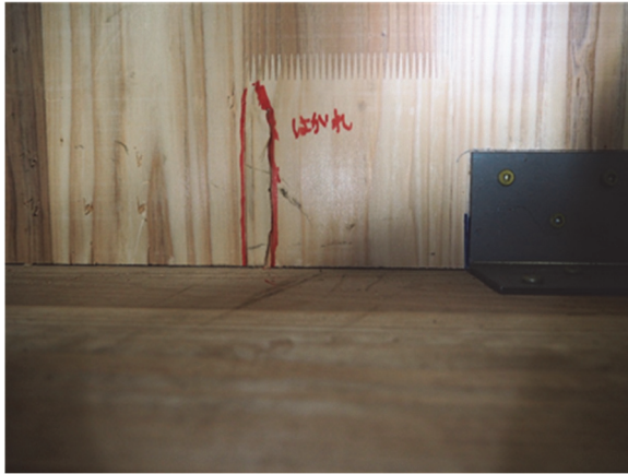
写真 8.7.2-55 壁パネル表層剥離
