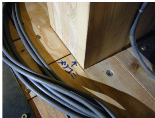
写真 8.7.1-311 壁パネルの床へのめり込み
