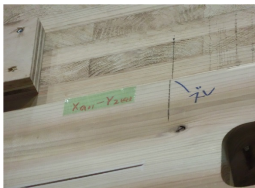
写真 8.7.1-23 床パネルと壁パネルのずれ
