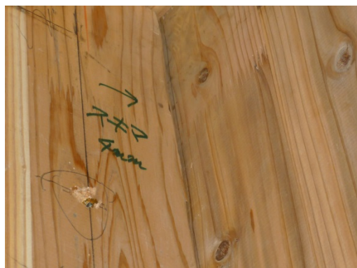
写真 8.7.1-77 壁パネルの開き
