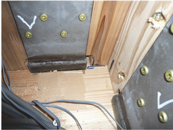
写真 8.7.2-57 壁のめり込み
