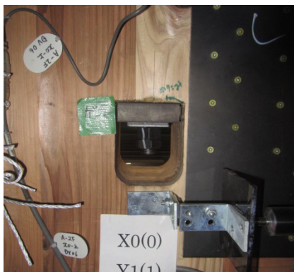
写真 8. 7. 1-167 壁-壁引きボルトのめり込み X1 通り
