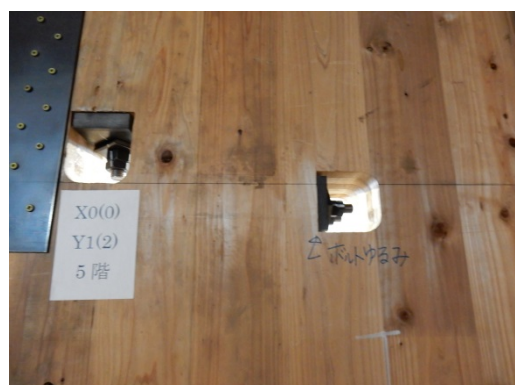
写真 8.7.1-325 壁-腰壁引きボルトの緩み
