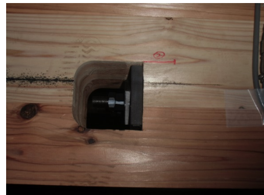
写真 8.7.1-164 壁-垂れ壁引きボルトの割れ
