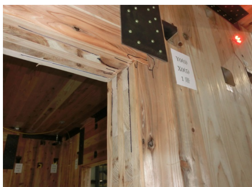
写真 8.7.1-39 垂れ壁と壁の側面割れ Y4 通り
