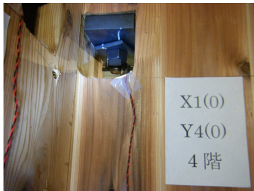
写真 8. 7. 1-300 壁-壁引きボルトの緩み Y0 通り
