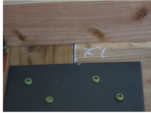
写真 8. 7. 1-222 垂れ壁と壁の開き
