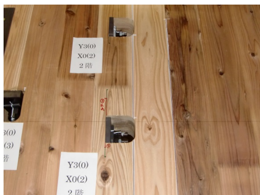
写真 8. 7. 1-176 壁-垂れ壁引きボルトの割れ
