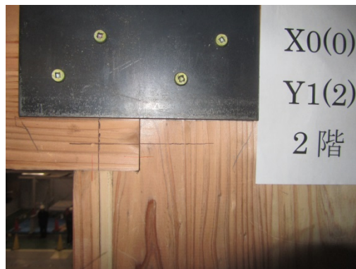
写真 8. 7. 1-157 垂れ壁パネルのずれ
