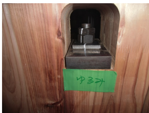
写真 8. 7. 1-172 壁-壁引きボルトの緩み
