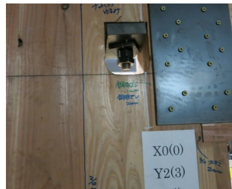
写真 8. 7. 1-103 垂れ壁-壁間せん断プレート ずれ
