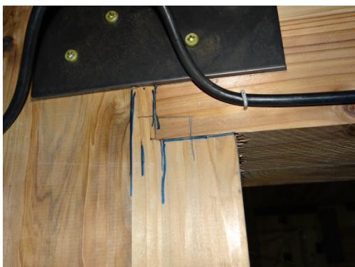
写真 8. 7. 1-133 垂れ壁-壁取り合い部の潰れ
