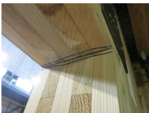
写真 8. 7. 1-251 垂れ壁と壁の開き
