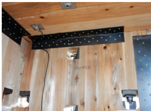
写真 8.7.1-322 壁-垂れ壁引きボルトの緩み
