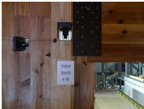
写真 8. 7. 1-294 垂れ壁と壁の開き Y1 通り
