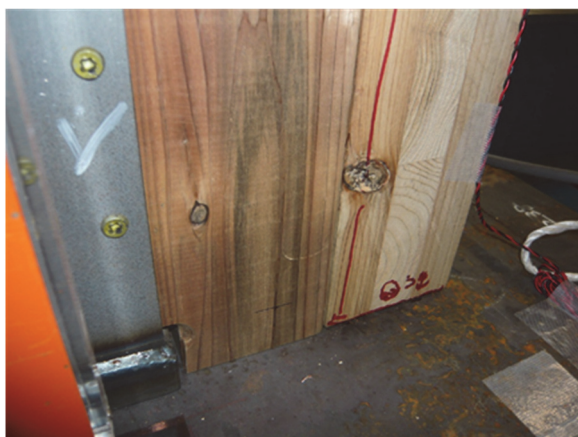
写真 8.7.2-10 壁パネルの浮き
