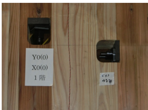
写真 8.7.1-16 壁-垂れ壁引きボルトの緩み
