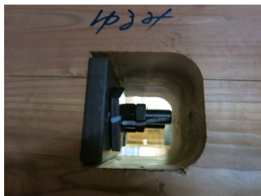
写真 8.7.1-285 壁-垂れ壁引きボルトの緩み
