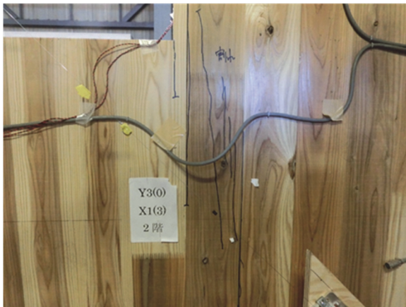
写真 8.7.2-54 壁パネル割れ
