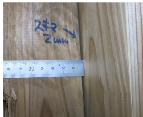
写真 8.7.1-149 壁パネル間の隙間
