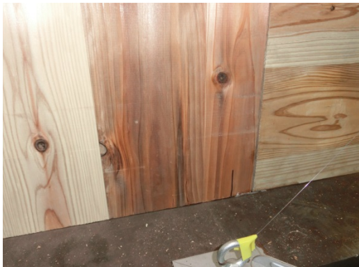
写真 8.7.1-31 壁と基礎の接触面からの割れ Y0 通り
