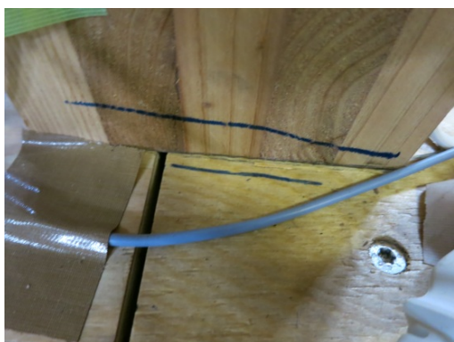
写真 8.7.1-284 壁パネルの床へのめり込み
