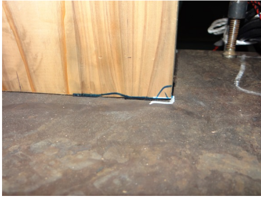
写真 8. 7. 1-135 壁パネル下部の潰れ
