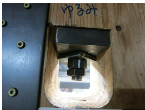
写真 8. 7. 1-260 壁-壁引きボルトの緩み
