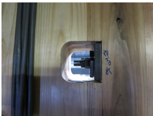
写真 8.7.1-247 引きボルトのナットの緩み
