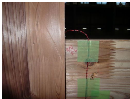
写真 8. 7. 1-160 腰壁パネルのずれ
