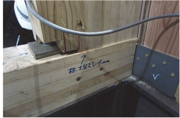
写真 8.7.2-31 柱・土台のずれ
