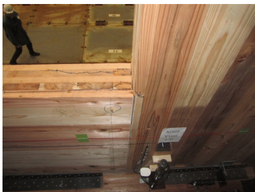
写真 8.7.1-184 壁パネルのめり込み
