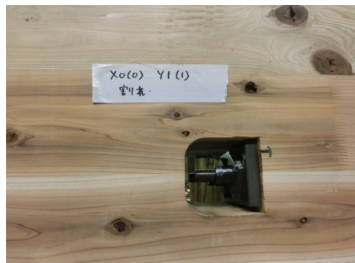
写真 8.7.1-14 壁-壁引きボルト座金からの割れ
