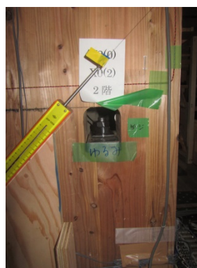
写真 8. 7. 1-209 壁-壁引きボルトの緩み
