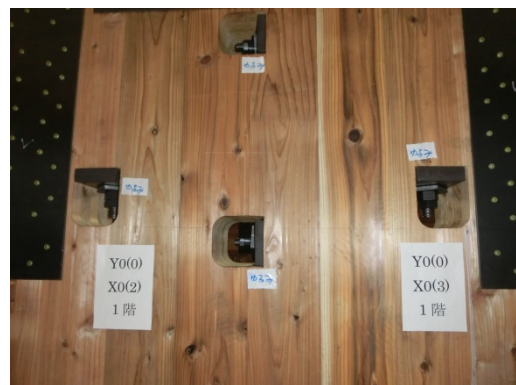
写真 8.7.1-36 各引きボルトの緩み
