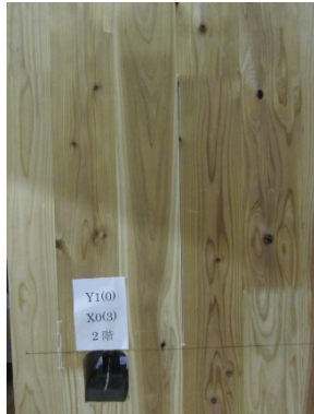
写真 8. 7. 1-153 ラミナ継目の割れ
