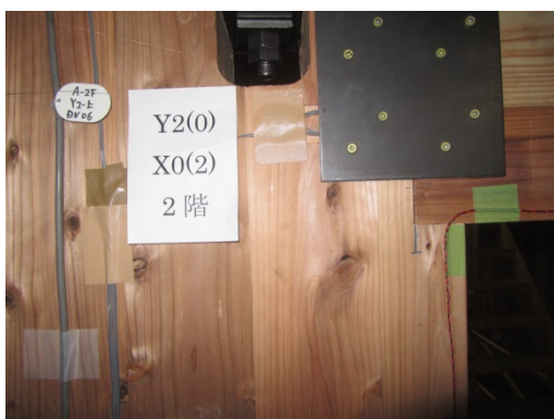
写真 8. 7. 1-208 垂れ壁パネル隅の割れ
