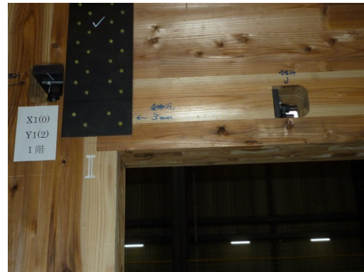
写真 8. 7. 1-115 壁-垂れ壁せん断プレート のずれと引きボルトの緩み
