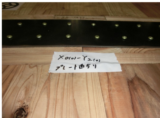
写真 8.7.1-13 床-床間せん断プレートの曲り
