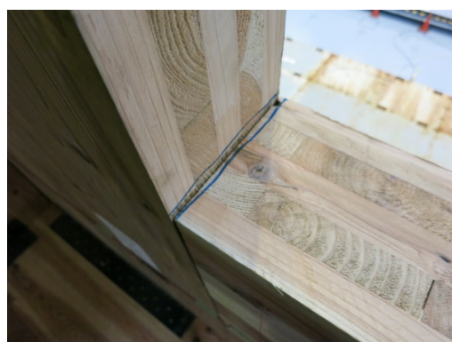
写真 8.7.1-268 腰壁と壁の開き
