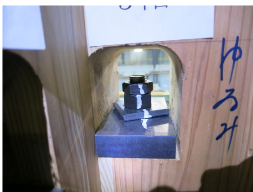
写真 8.7.1-267 壁-壁引きボルトの緩み Y0 通り
