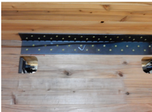
写真 8.7.1-314 ラミナの継ぎ目の割れ
