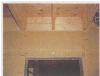
⑦ 開口部周りの石膏ボード割れ
