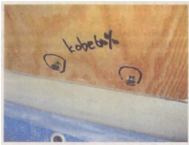
③ 合板釘抜け
