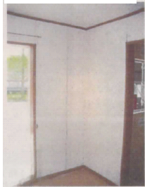
⑤ 内装仕上材の切れ
