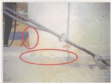
⑥ 釘周り石膏ボード圧壊
